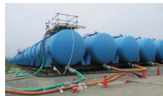
写真1 濃縮廃液用タンク
