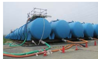
写真1 濃縮廃液用タンク
