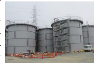
写真2 淡水貯蔵用タンク
