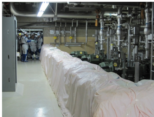
MUWC ポンプ室
