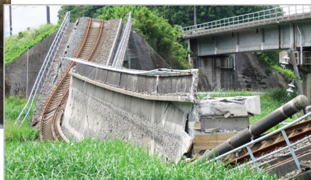
JR常磐線の橋梁が倒壊
