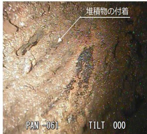
撮影場所A グレーチング脱落部②
