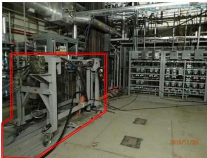
赤枠：対象機器 2号機原子炉建屋1階（北西）
