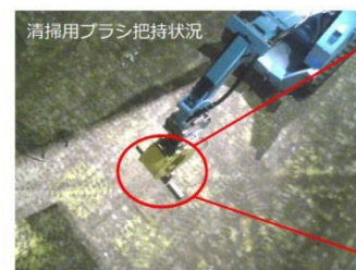
清掃用ブラシを用いて、床面の遊離性ダスト(砂等)を集め、集塵機で回収を行う。
