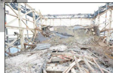
崩落屋根状況
