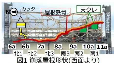
図1 崩落屋根形状(西面より)
