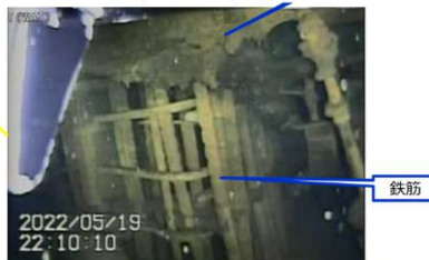
写真3.ペDESTAL開口部(右側基礎部)の堆積物より下部の状況
