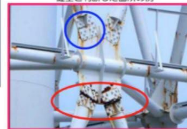
破断及び変形と判断した箇所の例
