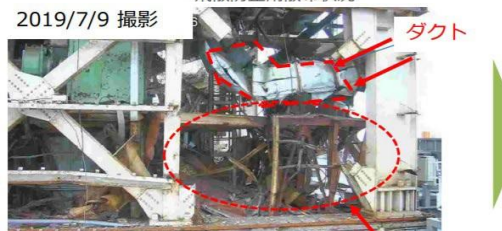
南側小ガレキ撤去前 既設架台等
