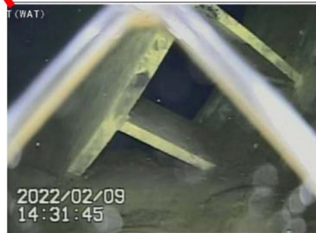
PCV東北東付近の状況（近接）
