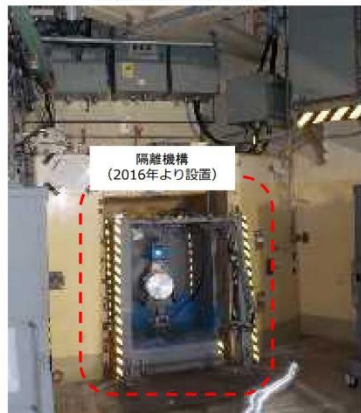
隔離機構取外し前
