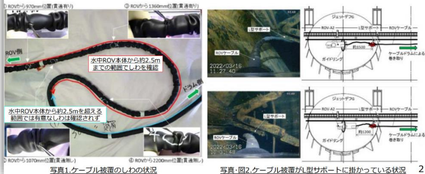
写真1.ケーブル被覆のしわの状況
