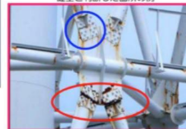
破断及び変形と判断した箇所の例
