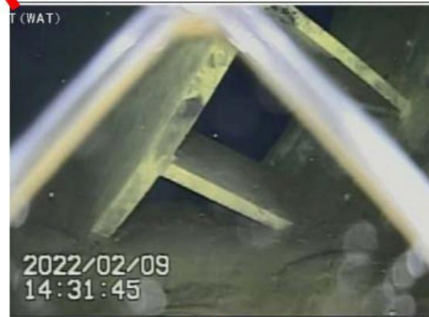
PCV東北東付近の状況(近接)
