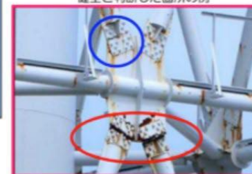
破断及び変形と判断した箇所の例
