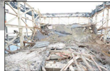
崩落屋根状況
