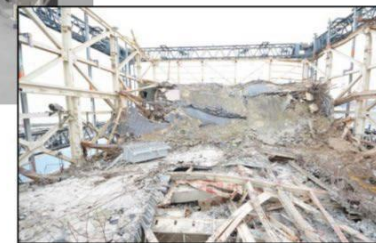
崩落屋根状況
