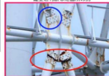
破断及び変形と判断した箇所の例
