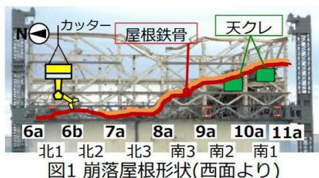
図1 崩落屋根形状(西面より)
