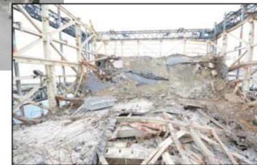
崩落屋根状況
