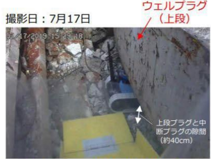
写真② 内部への侵入状況 (運搬ボックス内のカメラから撮影)
