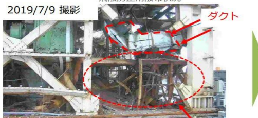
南側小ガレキ撤去前 既設架台等
