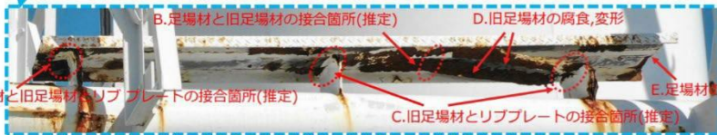
【写真③】足場落下箇所の西側隣接部
