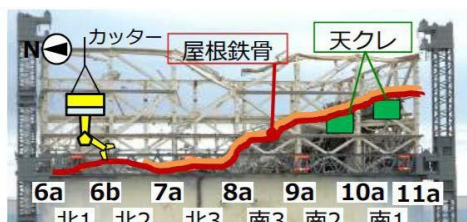
図1 崩落屋根形状(西面より)
