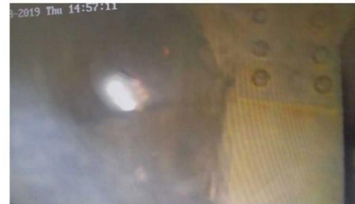
筒身内部支障物（H鋼）写真
