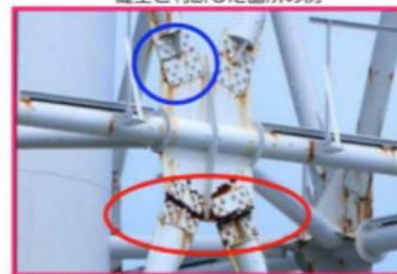
破断及び変形と判断した箇所の例
