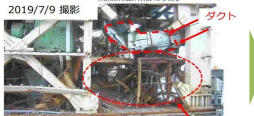
南側小ガレキ撤去前 既設架台等
