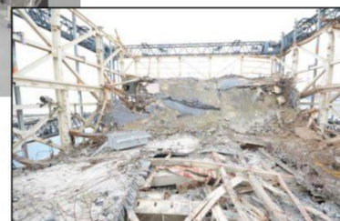
崩落屋根状況
