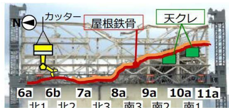
図1 崩落屋根形状(西面より)
