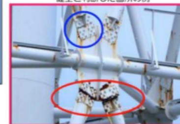
破断及び変形と判断した箇所の例
