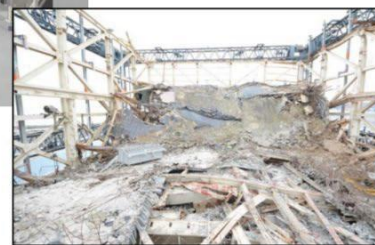
崩落屋根状況
