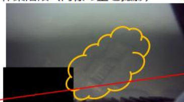
干渉物の例 (落下したダクト) ※移動済
