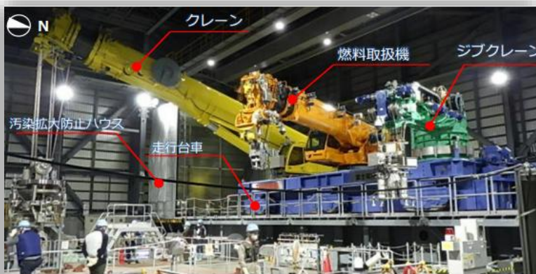
2025年9月8日 燃料取扱設備全景
