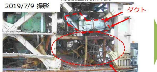
南側小ガレキ撤去前 既設架台等
