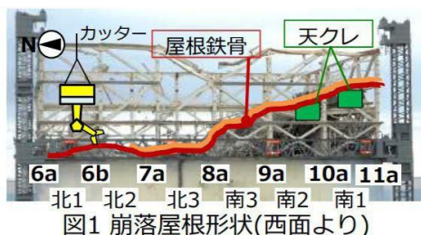
図1 崩落屋根形状(西面より)
