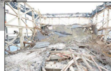
崩落屋根状況
