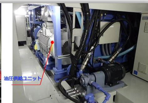
2025年8月5日 油圧供給ユニット（走行台車内部）
