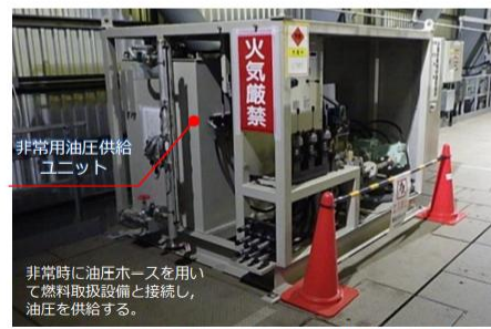
2025年8月5日 非常用油圧供給ユニット
