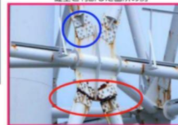
破断及び変形と判断した箇所の例
