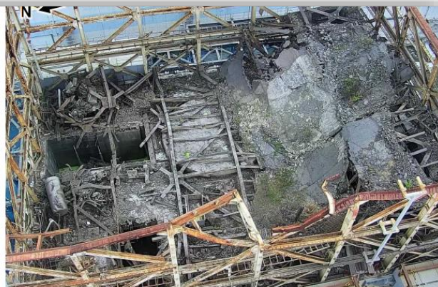
ガレキの状況 (大型カバー設置前)
