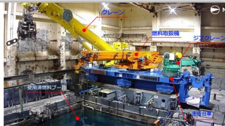
原子炉建屋内燃料取扱設備全景(遠隔監視カメラにて撮影) (撮影：2025年12月6日)
