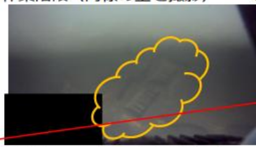
干渉物の例 (落下したダクト) ※移動済
