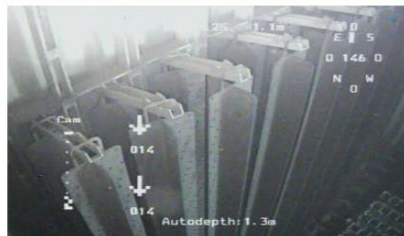
制御棒ハンガー（北東側）の様子
