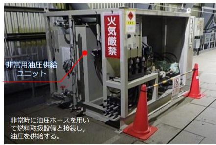
2025年8月5日 非常用油圧供給ユニット
