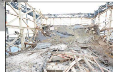
崩落屋根状況
