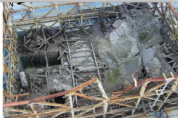
ガレキの状況 (大型カバー設置前)
