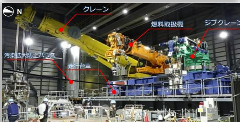
2025年9月8日 燃料取扱設備全景
