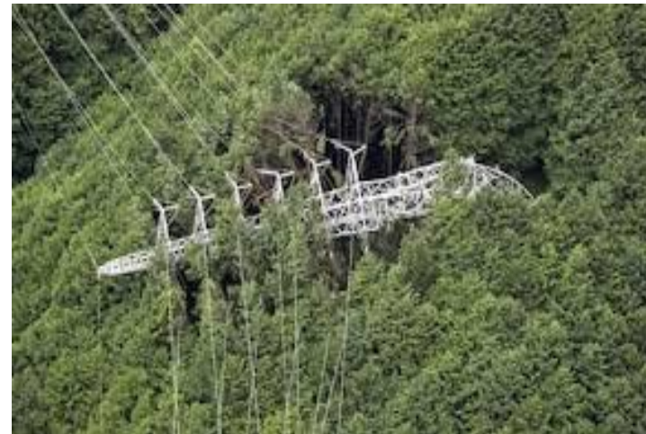
倒壊した送電鉄塔
