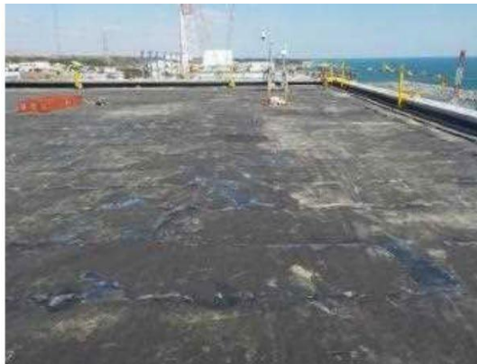
2R/B上屋対策状況
