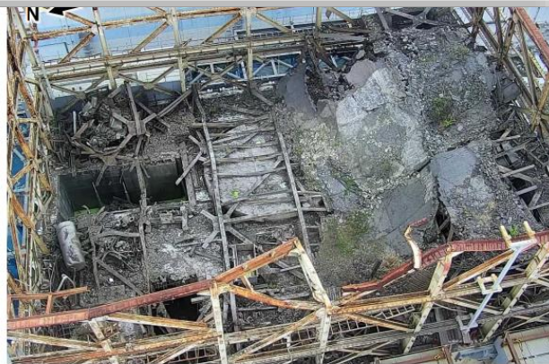
ガレキの状況(大型カバー設置前)
