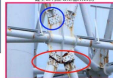
破断及び変形と判断した箇所の例
