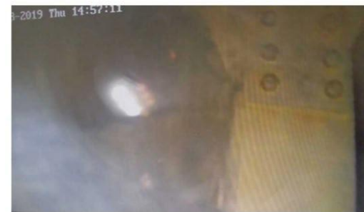
筒身内部支障物（H鋼）写真
