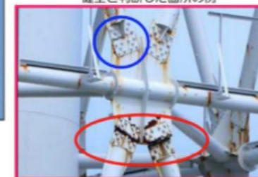
破断及び変形と判断した箇所の例
