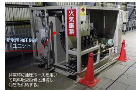
2025年8月5日 非常用油圧供給ユニット
