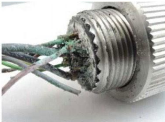
①接続部外観
