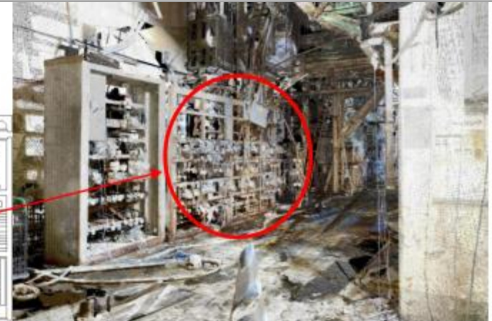
高圧注水系計装ラック (R/B 1階西)
