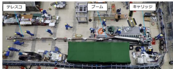
全体点検(メンテナンス)後の動作確認状況
