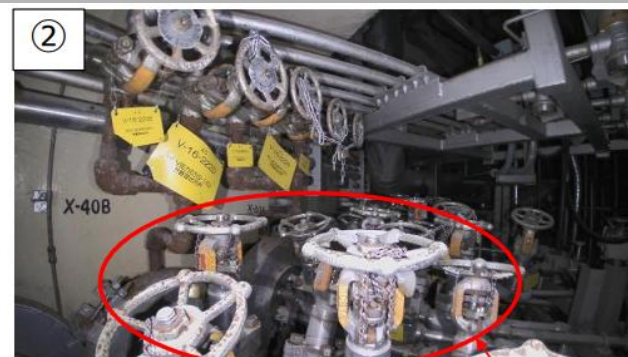
ジェットポンプ計装ライン
