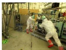
堆積物除去装置 (低圧水) 設置
