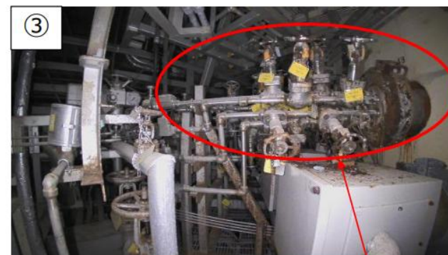
再循環ポンプ計装ライン
