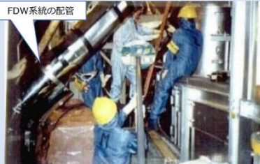
【震災前：定期検査時】FDW系統配管 FDW系統の配管
