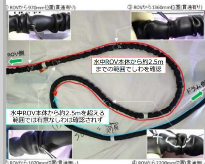
写真1. ケーブル被覆のしわの状況
