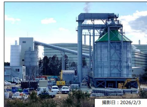
コンクリートプラント全景
