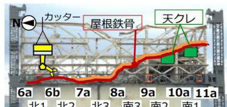
図1 崩落屋根形状(西面より)
