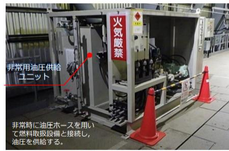
2025年8月5日 非常用油圧供給ユニット
